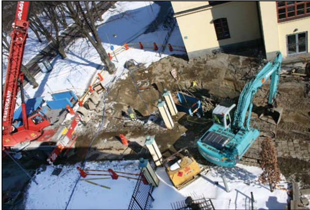
Ett datoriserat system för materialunderhåll hade kanske kunnat förutspå att denna läcka vid HiG vintern 2008 troligen skulle ske. Kanske hade det också visat att det var billigast att byta rören en längre sträcka.
